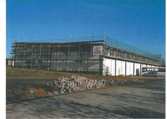
Handwerkliches Gründerzentrum: Die ehemalige Halle 16 wird nach ihrem Umbau ab Mitte des Jahres interessante Startmöglichkeiten für Existenzgründer im gewerblichen Bereich bieten.
